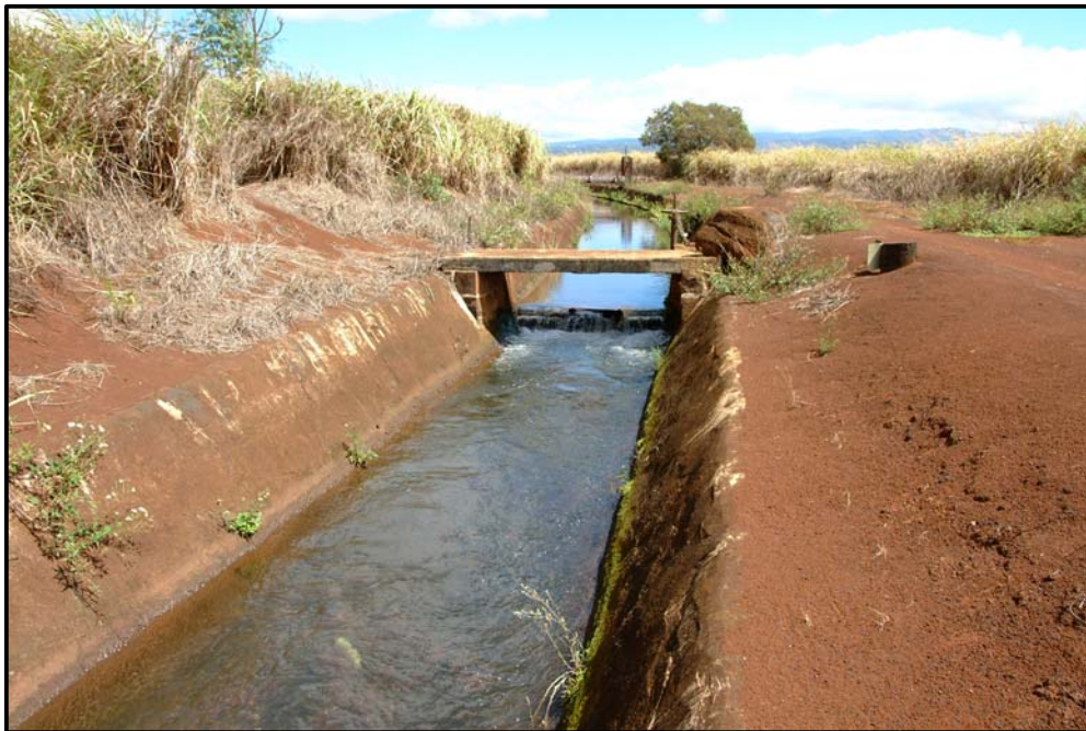
<사진 4-4> 오아후섬 Waiahole Ditch Irrigation System의 수로 모습
