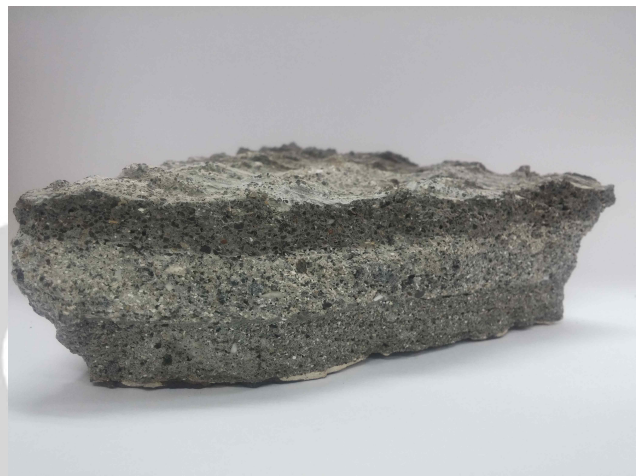
그림13. 제주 테쉬폰 구조물의 조각난 파편(목재 형틀에 가마니를 덮은 뒤 시멘트 모르타르를 3회 덧바름한 뒤 형틀과 가마니를 제거했다는 사실이 잘 드러난다) ©구조연구실+주택도시연구실
